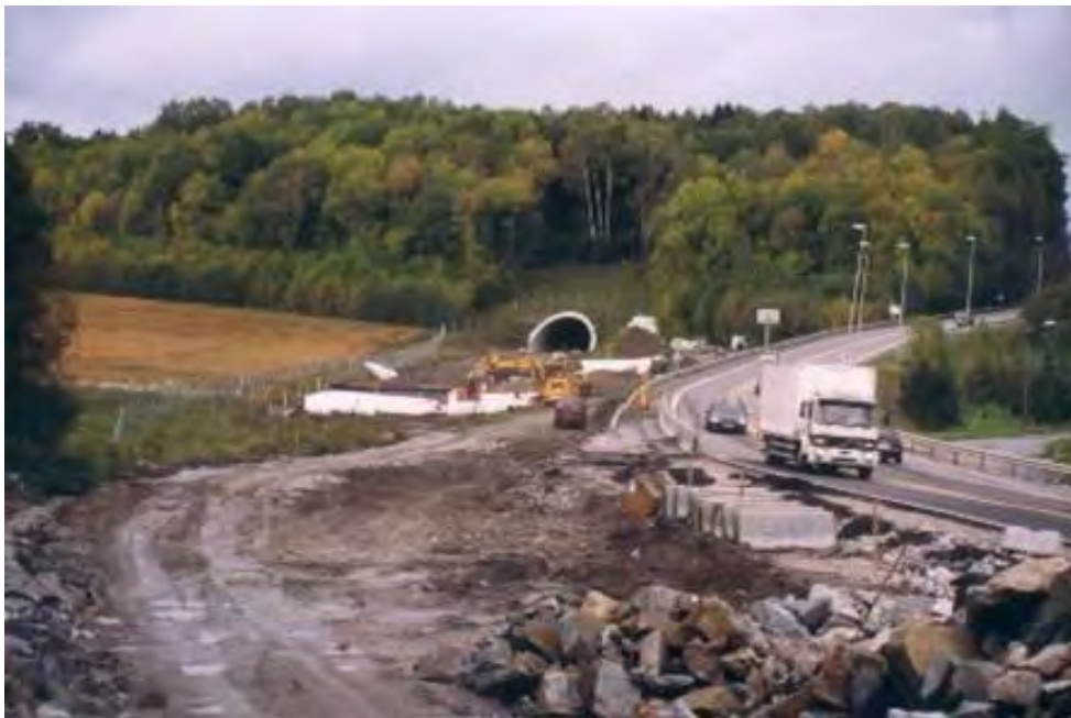
Figur 33. Utvidelse av eksisterende veg. E6 ved Smiehagen tunnel i Frogn kommune. Foto: Statens vegvesen
