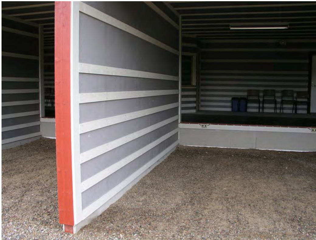
Figur 62: Moderne standplassoverbygg har frambygde absorbertkledte båsvegger som demper støyen betydelig
